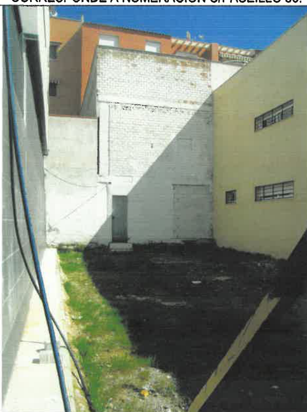
VISTA INTERIOR PARCELA 6C. SE OBSERVA LA MEDIANERÍA DEL EDIFICIO TRASERO (EDIF. COMPOSTELA) SIN ACABADO DE TERMINACIÓN DE ENFOSCADO.
