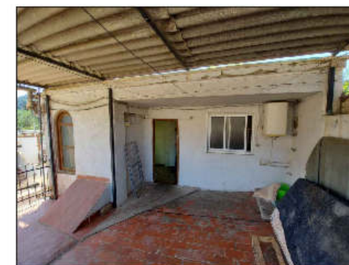
FOTO 3: TERRAZA PLANTA SEGUNDA (B+2) SE OBSERVA EL CUERPO DE EDIFICACION QUE NO RECOGIA POR ERROR EL PLAN ALBAYZIN
