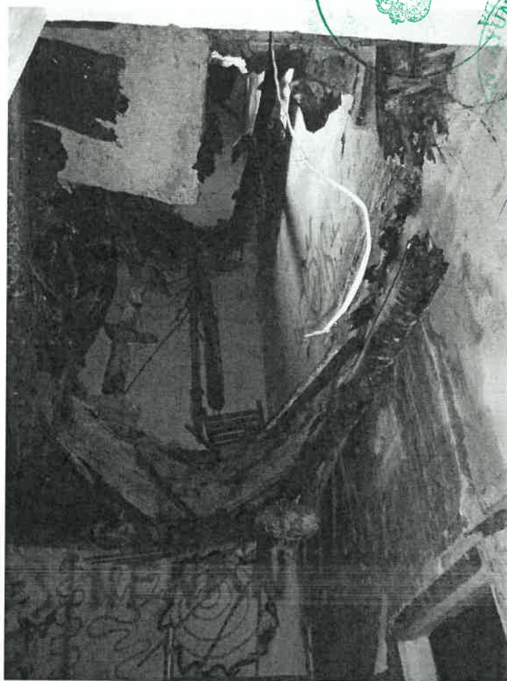
Imagen 15. Colapso forjados. Febrero 2019
