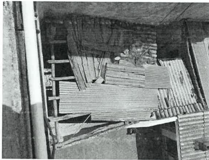
Imagen 06. Estado de la cubierta. Mayo 2018
