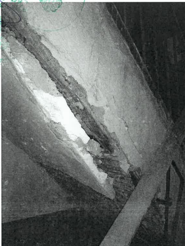
Imagen 16. Estado escalera. Febrero 2019
