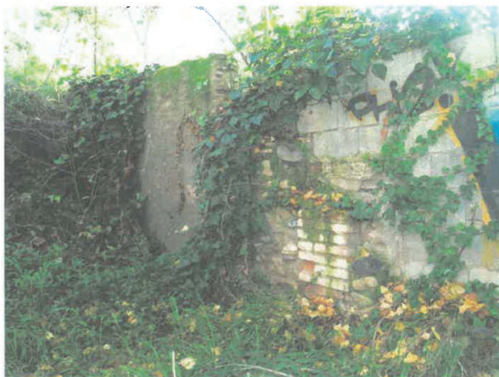
Foto 6.- Vista desde abajo del muro de cerramiento de la parcela, con partes antiguas realizadas en mampostería y ladrillo y otras más recientes (reparaciones realizadas con bloque).
