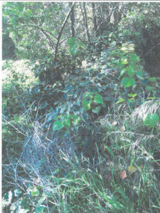
Foto9.-Muro de cerramiento cubierto de vegetación con los árboles al otro lado de la parcela.
