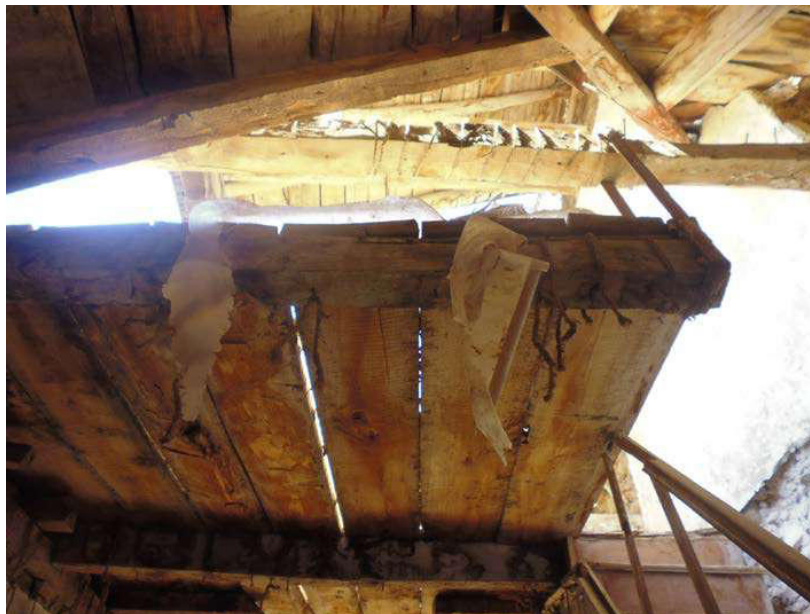
Fig. 17. Jácena de cierre de alfarje en planta primera para generar hueco de escalera de acceso al torreón. La viga se sustenta por una correa metálica que a su vez se ata a una viga del torreón de dudosa capacidad portante. (Fotografía de la autora).
