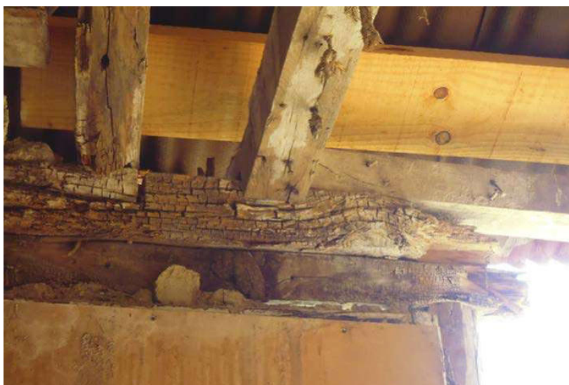
Fig. 19. Imagen que nos muestra claramente el estado de pudrición de las piezas estructurales de madera. (Fotografía de la autora).
