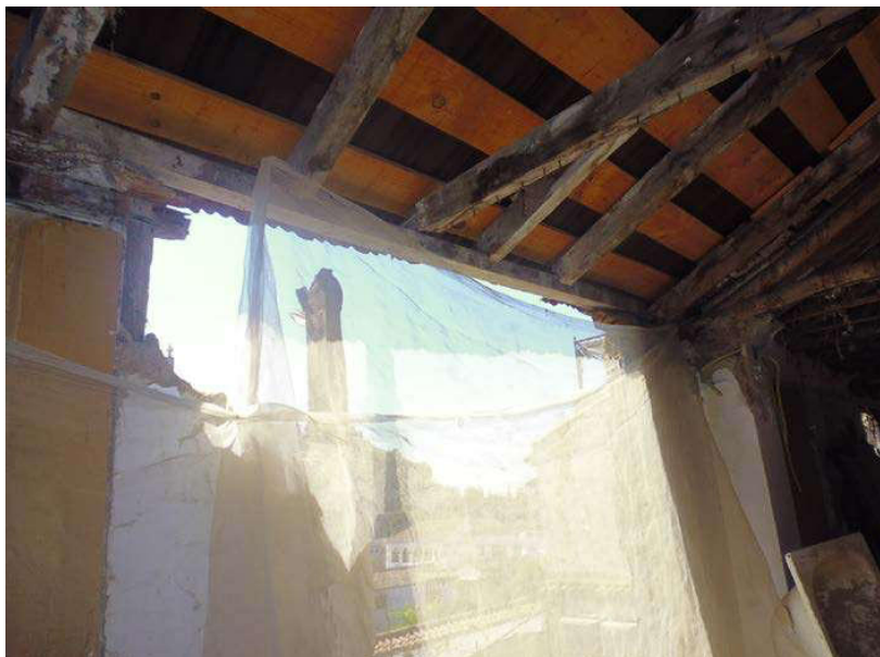
Fig. 18. Rotura de fachada. Pares que se apoyan en un nuevo estribo, pues el original se encuentra partido. (Fotografía de la autora).
