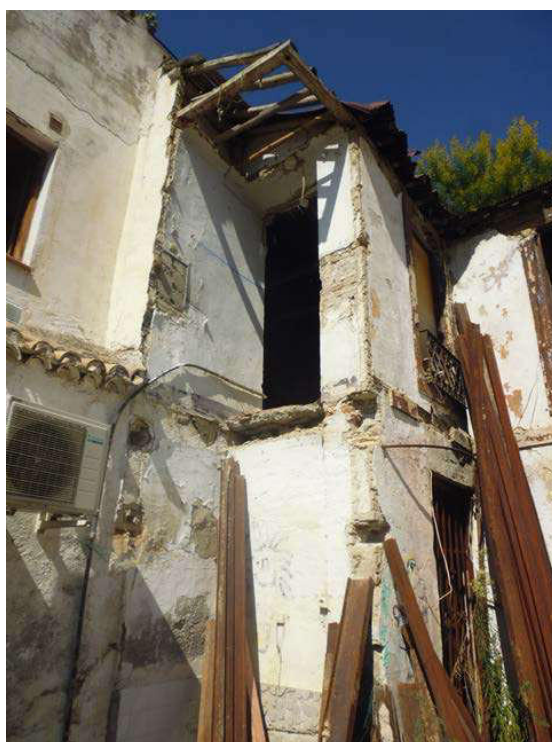
Fig. 6. Parte de la fachada donde se añadió un pequeño cuerpo que hubo de ser demolido. (Fotografía de la autora).
