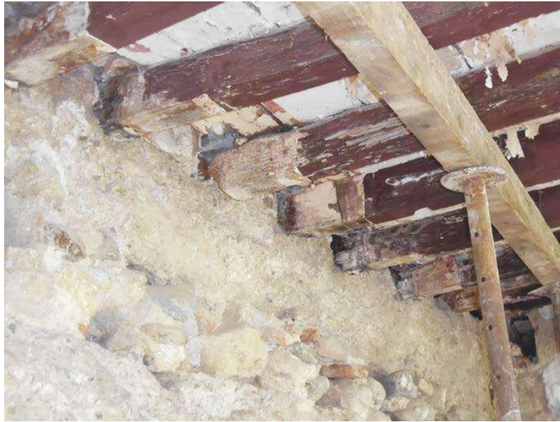
Fig. 16. Cabezas de vigas en el alfarje de planta baja empotradas en la muralla zirí. Se puede observar el estado de pudrición de estas piezas y las huellas en ellas de la existencia del tabique, elemento que en realidad sustentaba este techo. (Fotografía de la autora).
