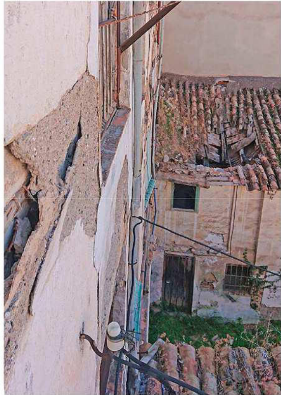
28.- Detalle mal estado de las cubiertas
