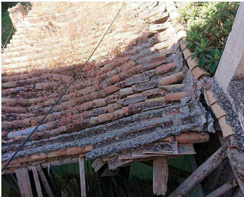
27.- Detalle mal estado de las cubiertas
