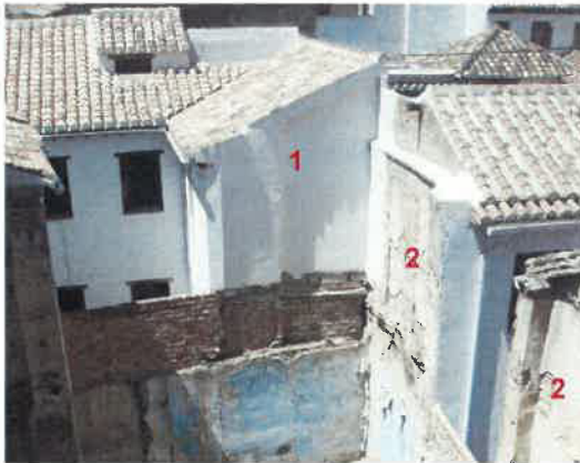
VISTA ACTUAL DE LA MEDIANERA DE LA EDIFICACIÓN COLINDANTE 1 y 2
