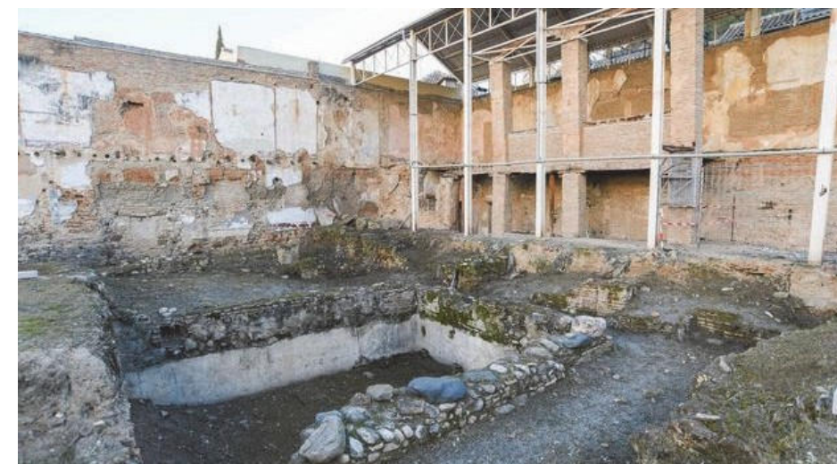
Estado en el que se encontraba el Maristán cuando en febrero de 2020 comenzaron los trabajos de restauración.
