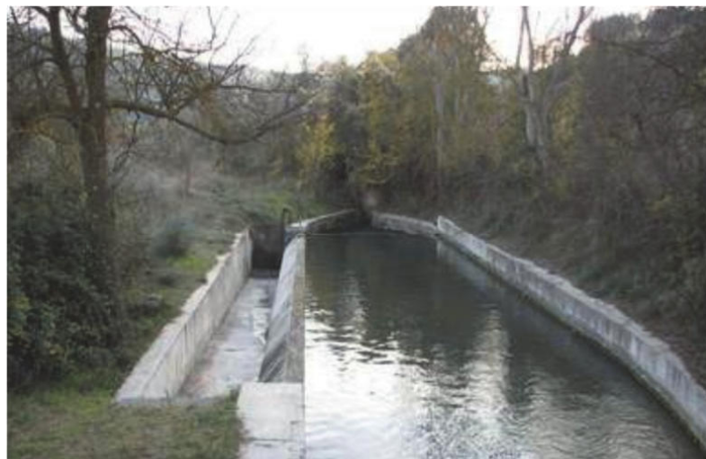
Acequia Real. Toma el agua en la Presa Real y avanza en paralelo al curso del río Darro, por su margen derecha, por la ladera Norte del Cerro del Sol. Es el elemento esencial del sistema hidráulico de la ciudad palatina de la Alhambra.
